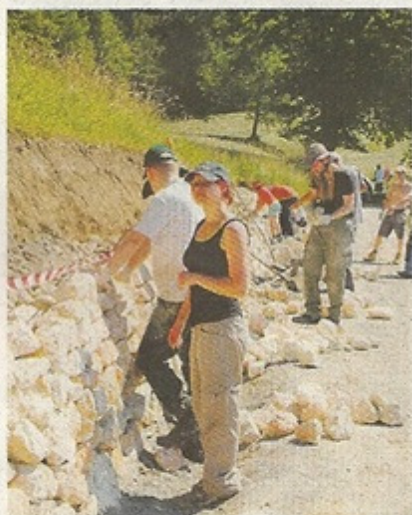
Gemeinsam gehts flugs: Am ersten Arbeitstag waren die Steine am Ende, nicht aber die Maurer. (Bilder: Diana Suter)
